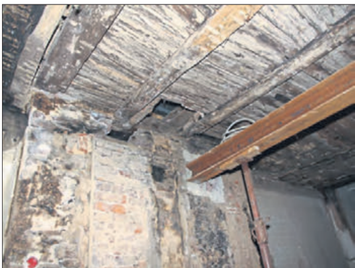
Stützen nötig: Die Decken müssen an mehreren Stellen abgesichert werden.
